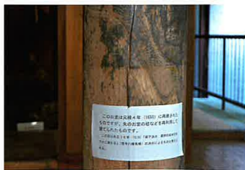
洪水の痕跡が残る柱(上宇内薬師堂内)
